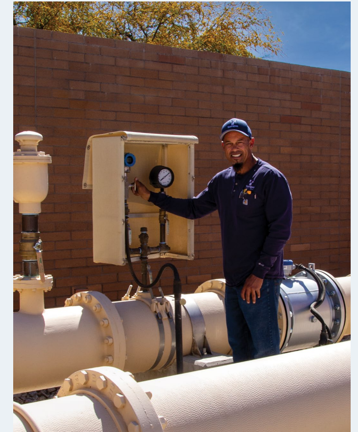
El técnico de instrumentación y control inspecciona un medidor en el lugar del pozo
