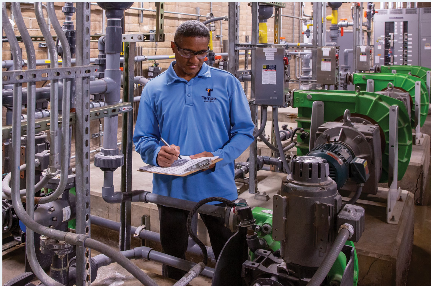
El operador de la planta revisa el equipo de desinfección.
