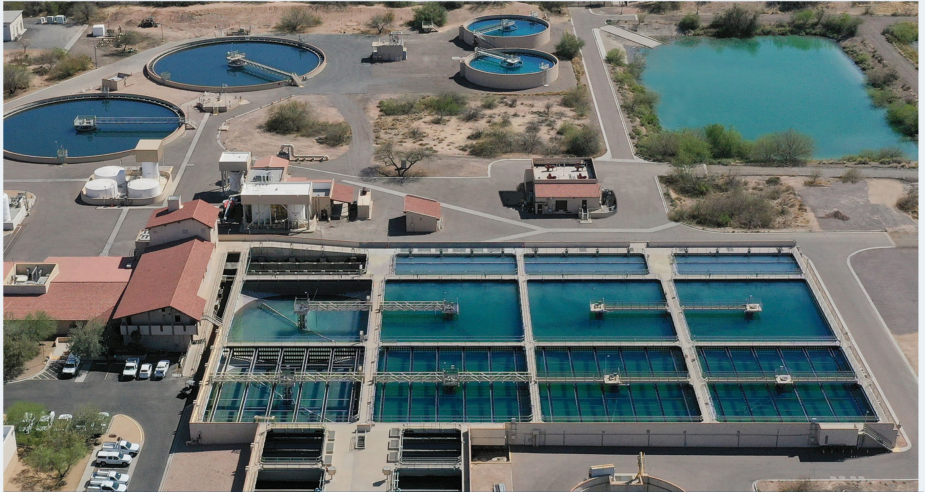
La Planta de tratamiento de agua de South Tempe trata el agua para hasta los más altos estándares de calidad.
