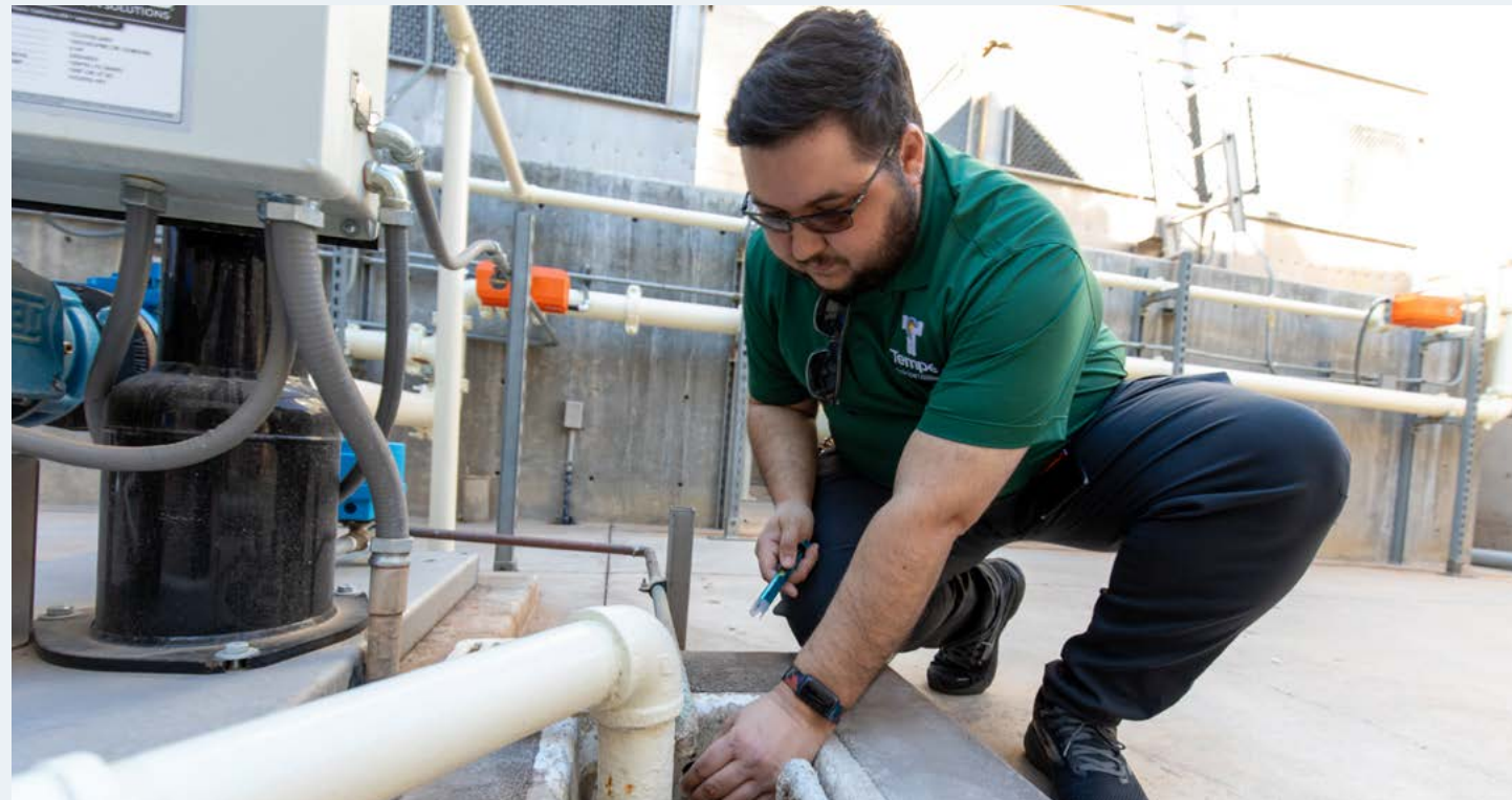
Los coordinadores del programa de conservación de agua evalúan mejoras de infraestructura para programas de incentivos, como el reembolso de la torre de enfriamiento, para garantizar aumentos significativos y permanentes en la eficiencia del uso del agua.
